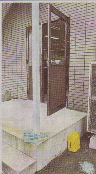
ガラスが割られた江津市役所分庁舎の裏口—同市江津町
